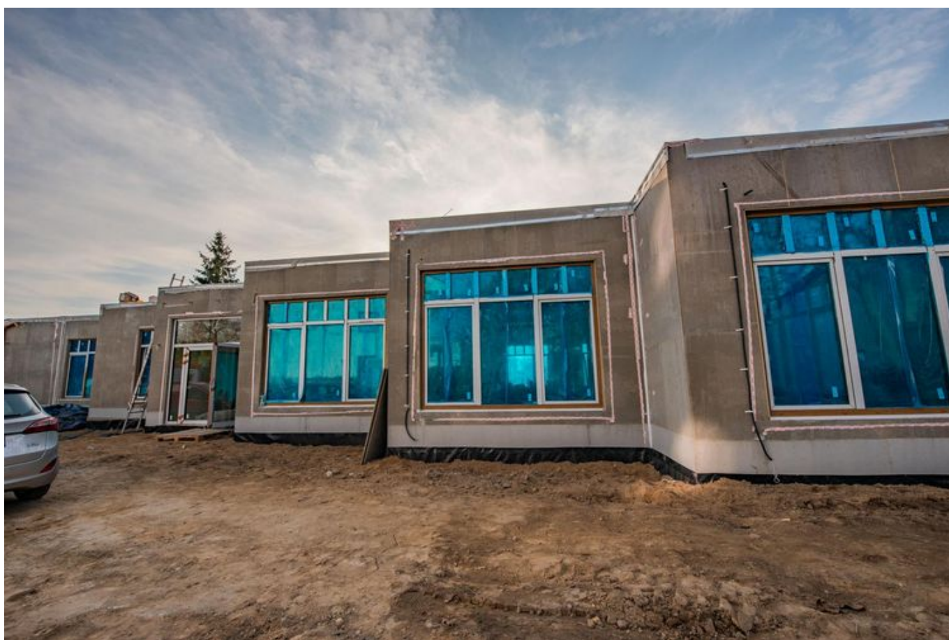
Na Olechowie powstaje żłobek zbudowany w technologii modułowej , fot. Radosław Żydowicz / UMŁ
