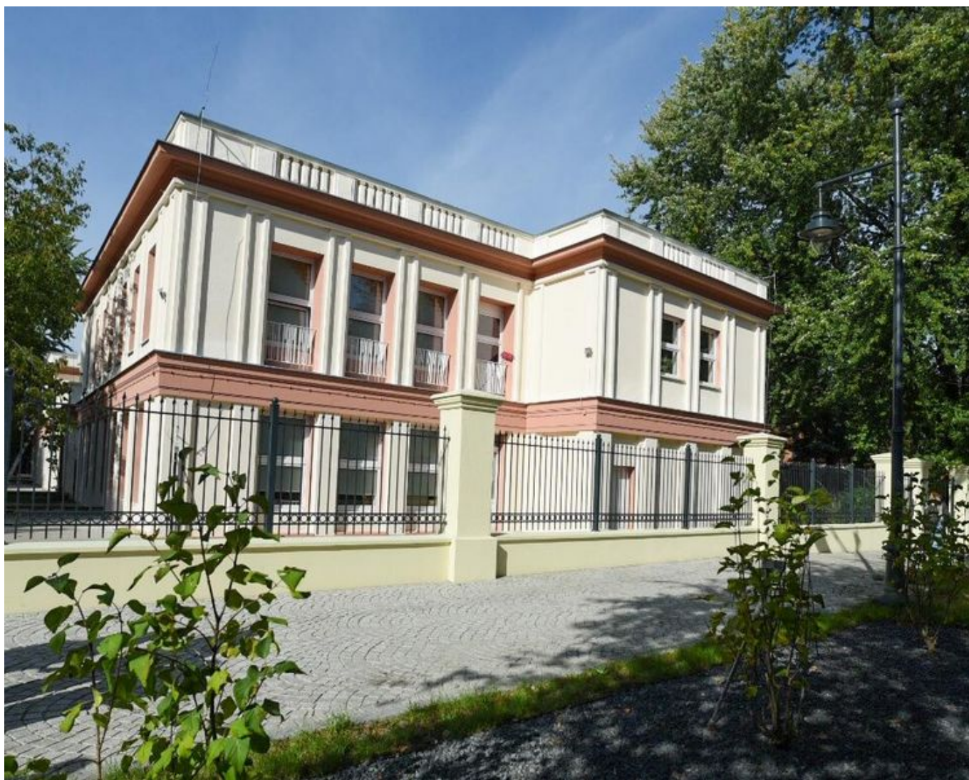
Kończy się kompleksowy remont miejskiego żłobka przy ul. Zachodniej 55A , fot. Paweł Łacheta / UMŁ
